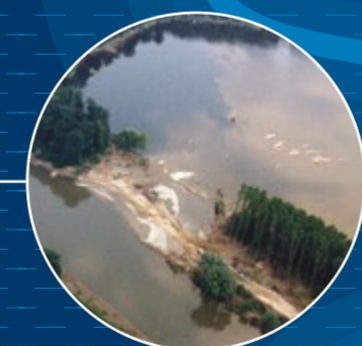
Protřetí levoběžní hráz řeky Moravy u Tlumačova (Štěrkově)
