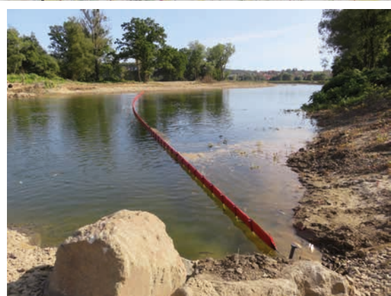
Normá stěna na řece Bečvě pro záchyt uhynulých ryb v Ústí, instalace 20. 9. 2020
