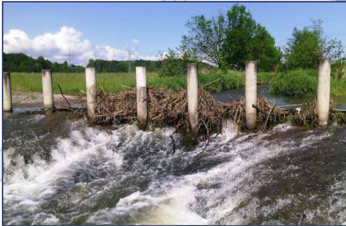
Plaveniny zachycené na železobetonových sloupcích před výpustným objektem
