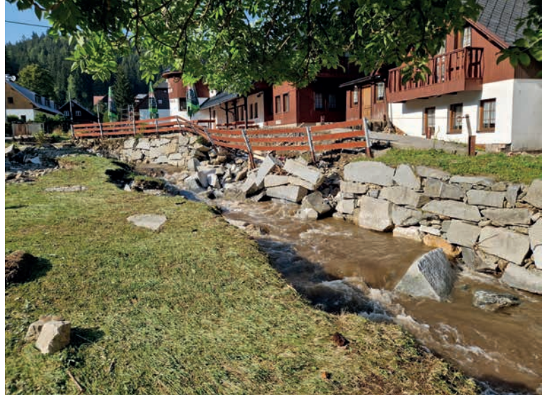
Povodňová škoda na opěrné zdi řeky Branné v Petřikově ↑
