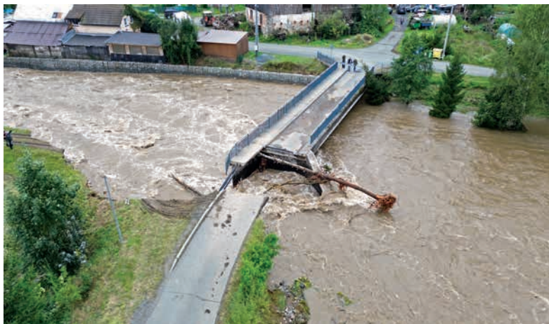
Poničený most přes řeku Moravu v Hanušovicích 14. 9. 2024 ↑
