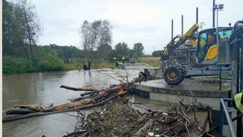
Zásah mechanizace na jezu Litovel si vyžádalo množství naplavenin blokuujících průtočnost řeky Moravy ↑
