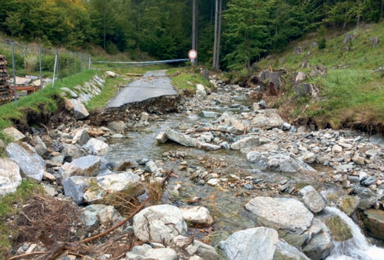
↑ Řeka Branná – poškozená komunikace v Ostružné
