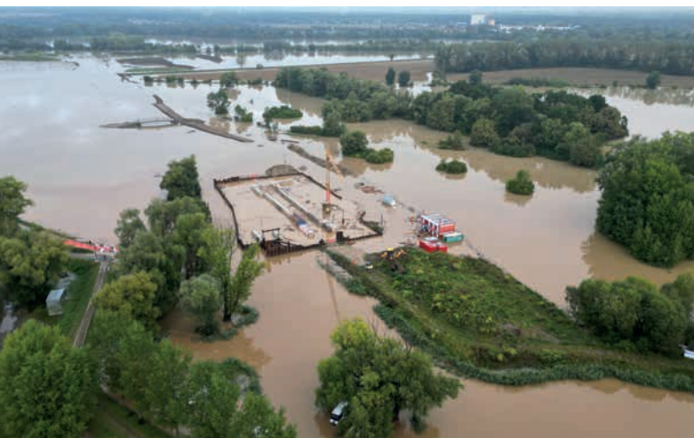
↑ Zaplavená stavba plavební komory Sudoměřice
