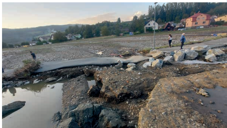
Poškozená cyklostezka podél ochranné hráze Moravy v Rudě nad Moravou ↑
